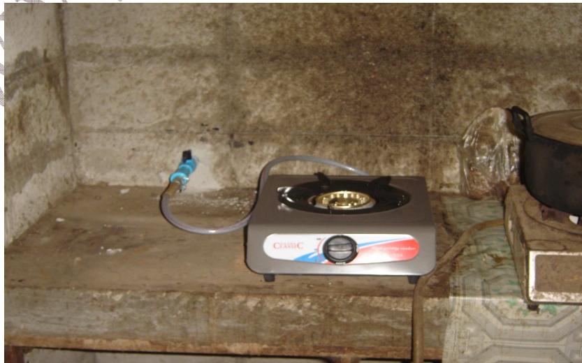
ต่อท่อนำก๊าซจากถุกเก็บก๊าซมายังเตาที่ทำการปรับแต่งแล้วทำวาล์วปิดเปิดก่อนต่อเข้าเตา
